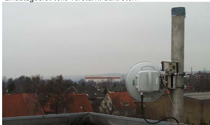
Antenne auf dem Gebäude der Firma Reinhold, Höhe 13m über Grund. Im Hintergrund: die Gegenseite, das W&H-Hochregallager.
